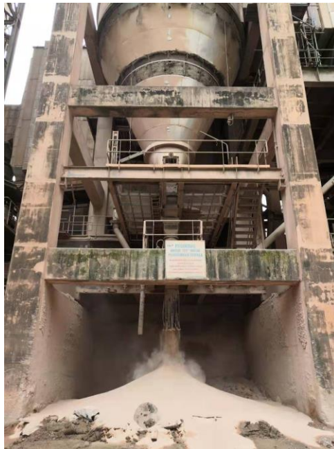
图 11 现场实际运行后蒸发冷却塔底出灰图
